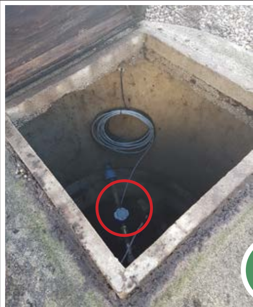
Die Zusatzantenne ist am Zähler im Schacht montiert. Das Kabel hat die korrekte Länge.
