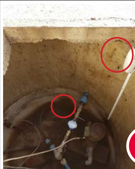
Zähler mit Schachtantenne. Die Antenne ist unter dem Schachtdeckel montiert, was keine besseren Signalbedingungen ergibt.
