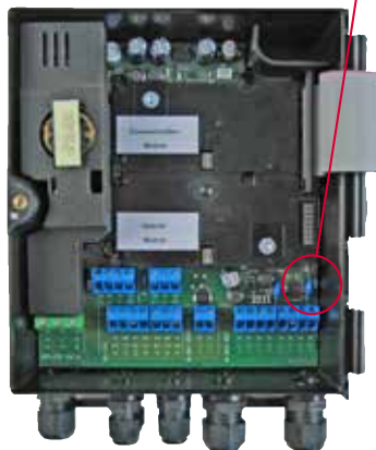
Colocación de jumper de máster/repetidor
