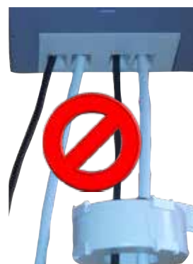
Bilde 10. Feil montering av strømtransformator ved 1-fase måler.
