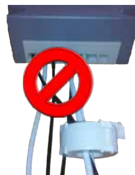
Bilde 8. Feil montering av strømtransformator ved 3-fase måler.
